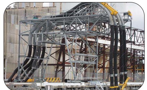
Terminaux de déchargement
